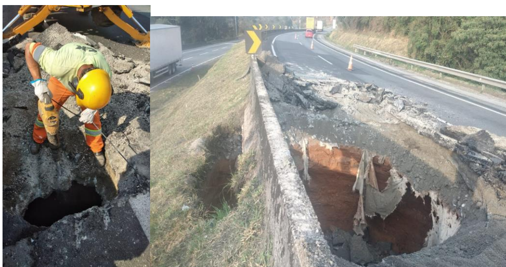
Figura 3.3 - Vazio identificado sob o pavimento.
