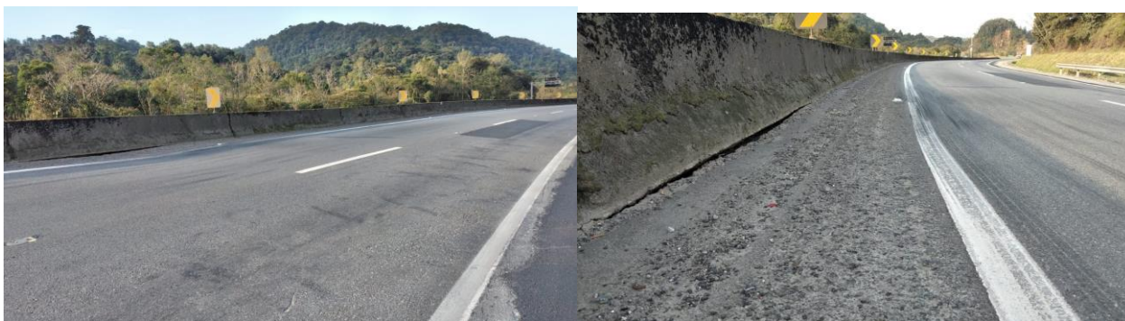
Figura 3.2 - Recalques localizados na faixa 1 da pista Norte.
