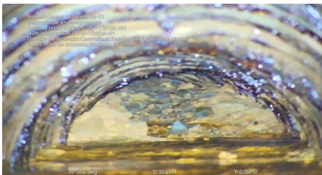
Figura 3.18 - Material depositado no limite da inspeção pelo montante.
