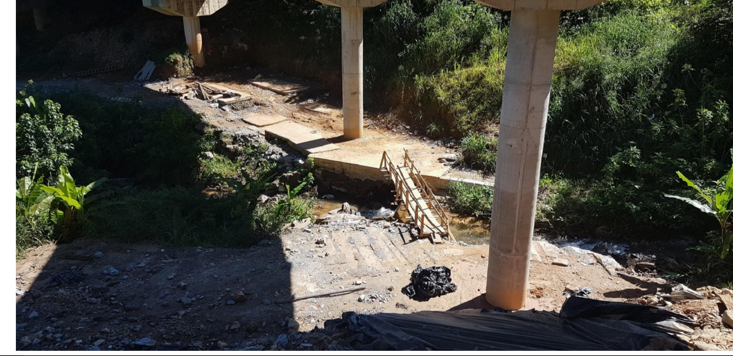
FOTO 01: BASES DE CONCRETO ARMADO, MANTIDAS PELA SOLICITAÇÃO DA APR.
