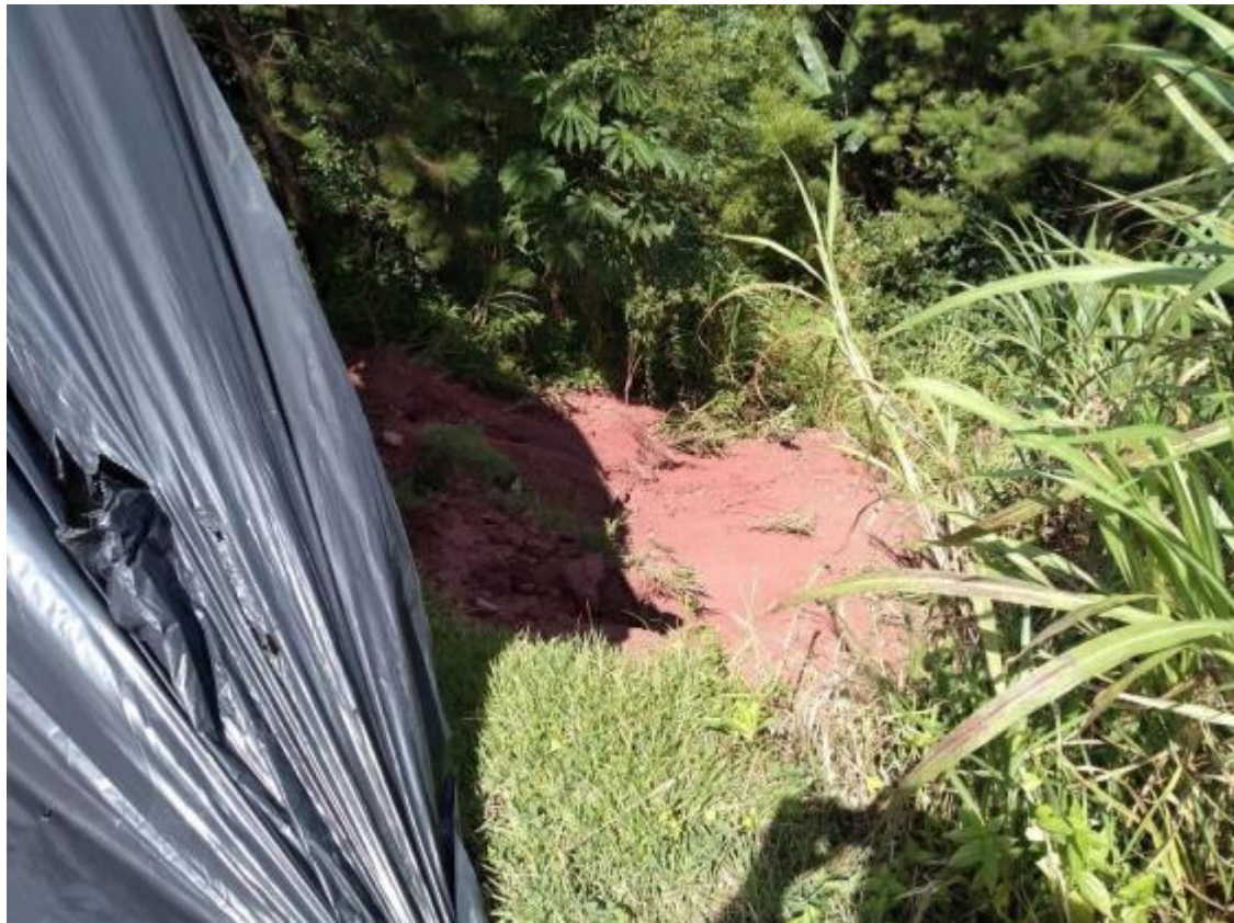
Vista para o pé do muro com material decorrente da ruptura.
