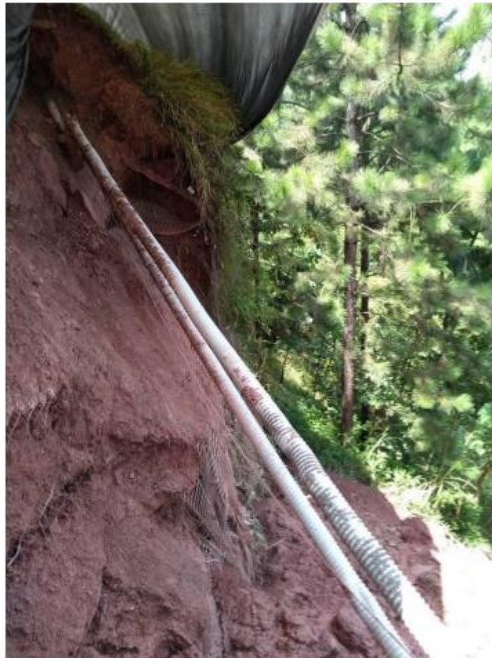
Vista lateral da face do muro de solo reforçado, geogrelhas expostas e rompidas – nota-se condutos de utilidades (elétrica, fibras etc.) pendurados na borda da ruptura.
