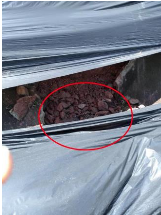
Resquícios de geogrelhas junto ao maciço rompido.
