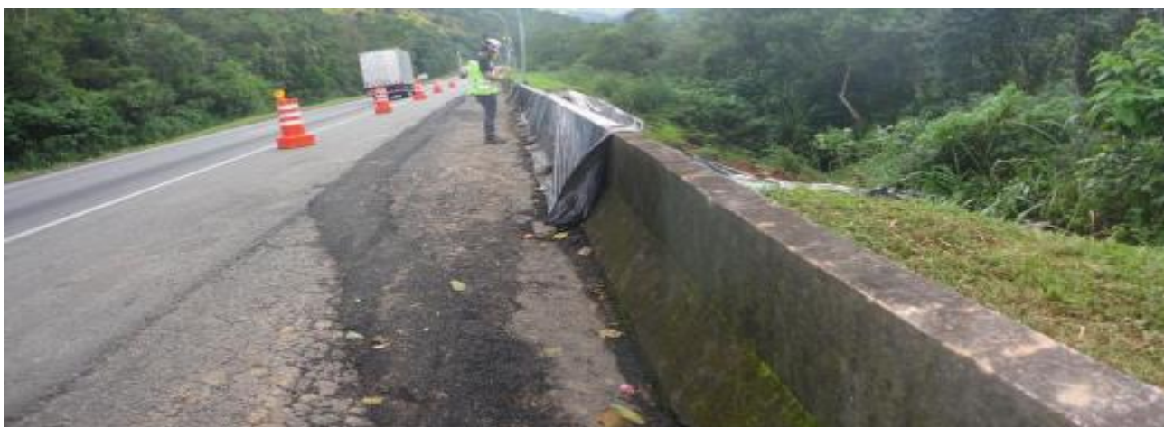
Foto 8: Vista do escorregamento a partir do acostamento; em primeiro plano a trinca selada com betume, à esquerda, o acostamento interditado.
