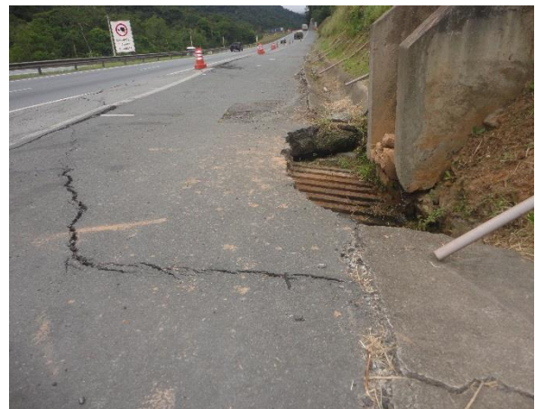
Foto 8: Aspecto de possível deslocamento da descida d'água sobre a caixa de passagem.
