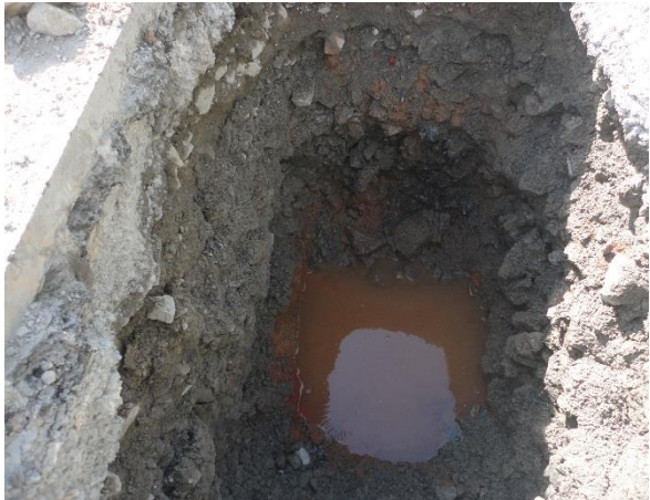
Foto 5: Surgência d'água na camada de rachão sob a estrutura do pavimento.
