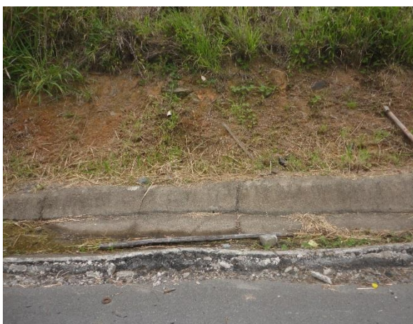
Foto 3: Esmagamento da sarjeta de pista junto ao bordo do pavimento.
