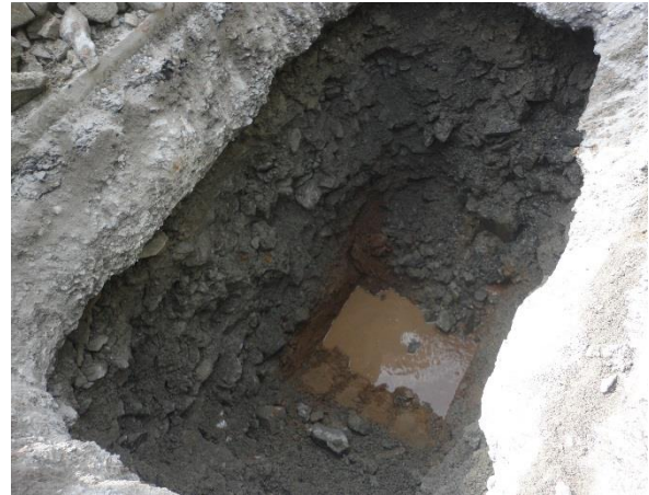
Foto 6: Rachão saturado sob a estrutura do pavimento com vestígio do tubo dreno.
