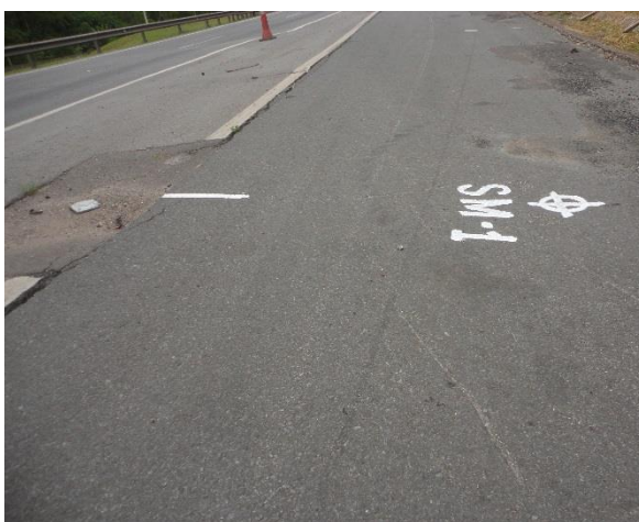
Foto 1: Trinca longitudinal atingindo o acostamento e a faixa 3.
