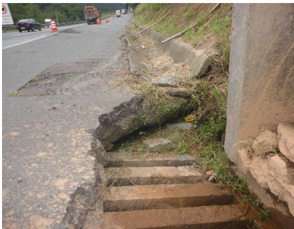
Foto 7: Soerguimento do pavimento junto à caixa de passagem.
