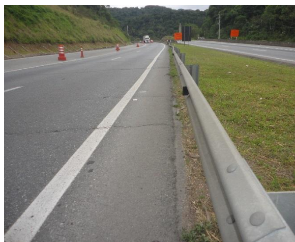
Foto 2: Trincas transversais atingindo as faixas 1 e 2.
