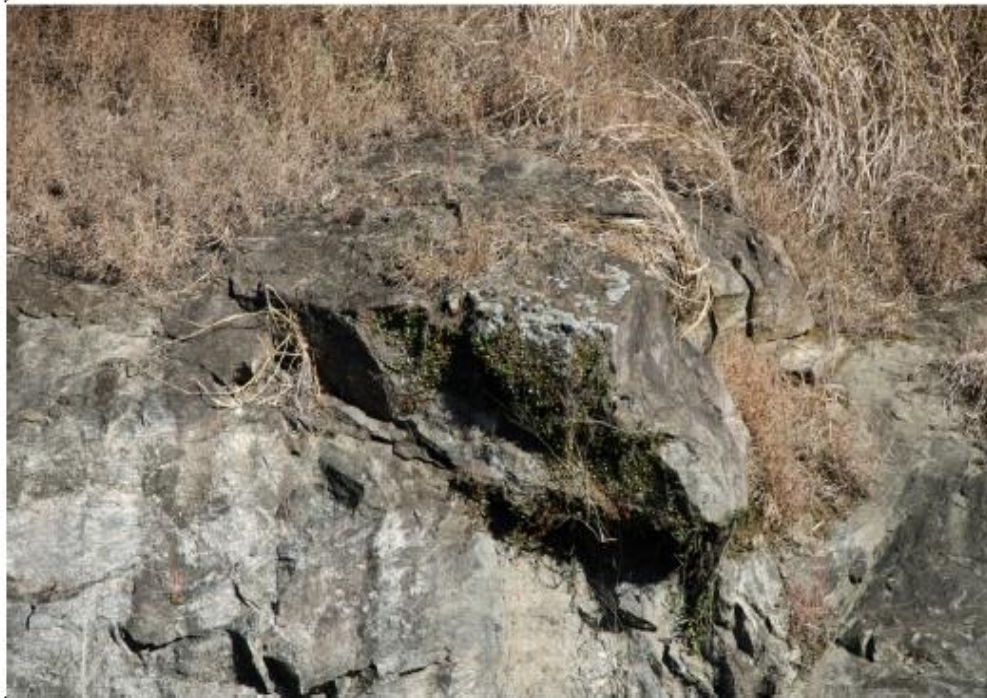
Figura 2.3-1 - Bloco formado na intersecção de planos de fraturas em cotas mais altas do talude.
