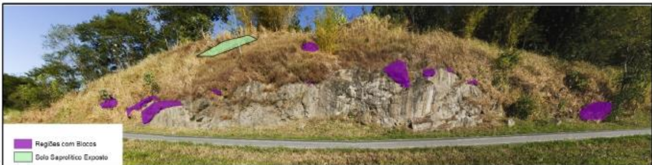
Figura 2.3-6 - Regiões com formação de blocos rochosos instáveis no Talude “km 402 + 800 m”.
