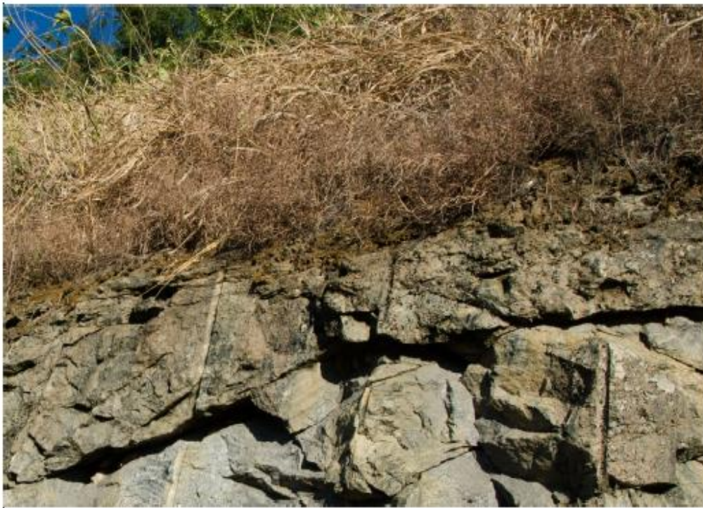
Figura 2.1-5 - Interface rocha e solo saprolítico, material mais alterado no topo do alforamento rochoso.
