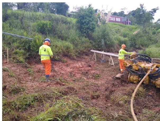
Foto 5: Instalação de drenos horizontais profundos (DHP's) visando o rebaixamento do N.A. observado nas sondagens executadas.
