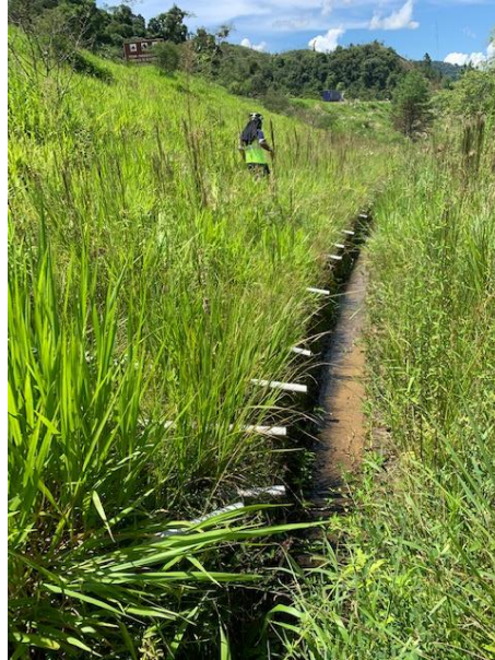
Foto 6: DHP's instalados na saia do aterro, apresentando gotejamento e filete d'água, em foto tirada em 03/02/2021.
