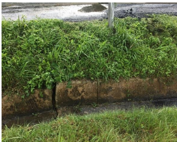
Foto 2: Sequência da trinca atingindo a canaleta existente.
