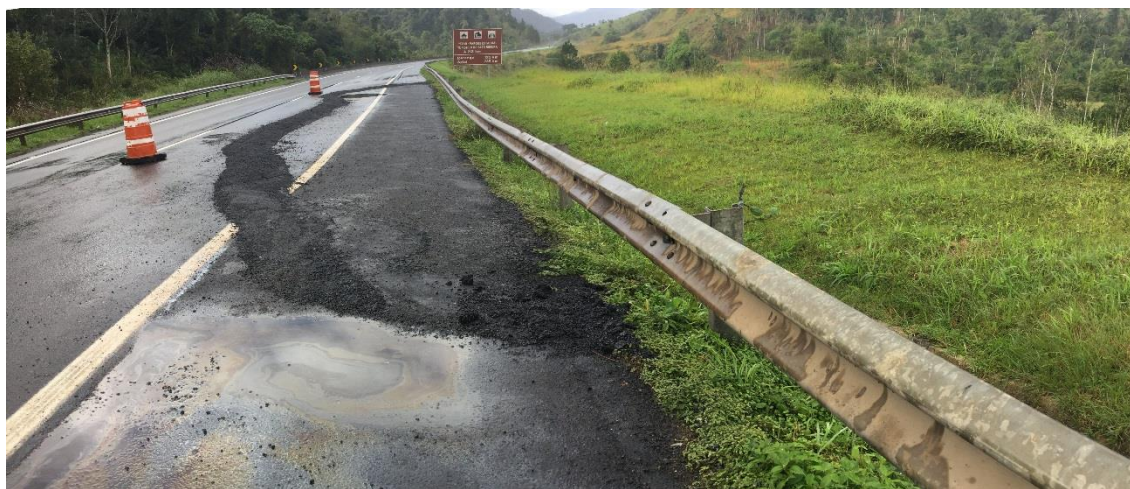
Foto 1: Vista da trinca desenvolvendo-se pela Faixa 2 e acostamento
