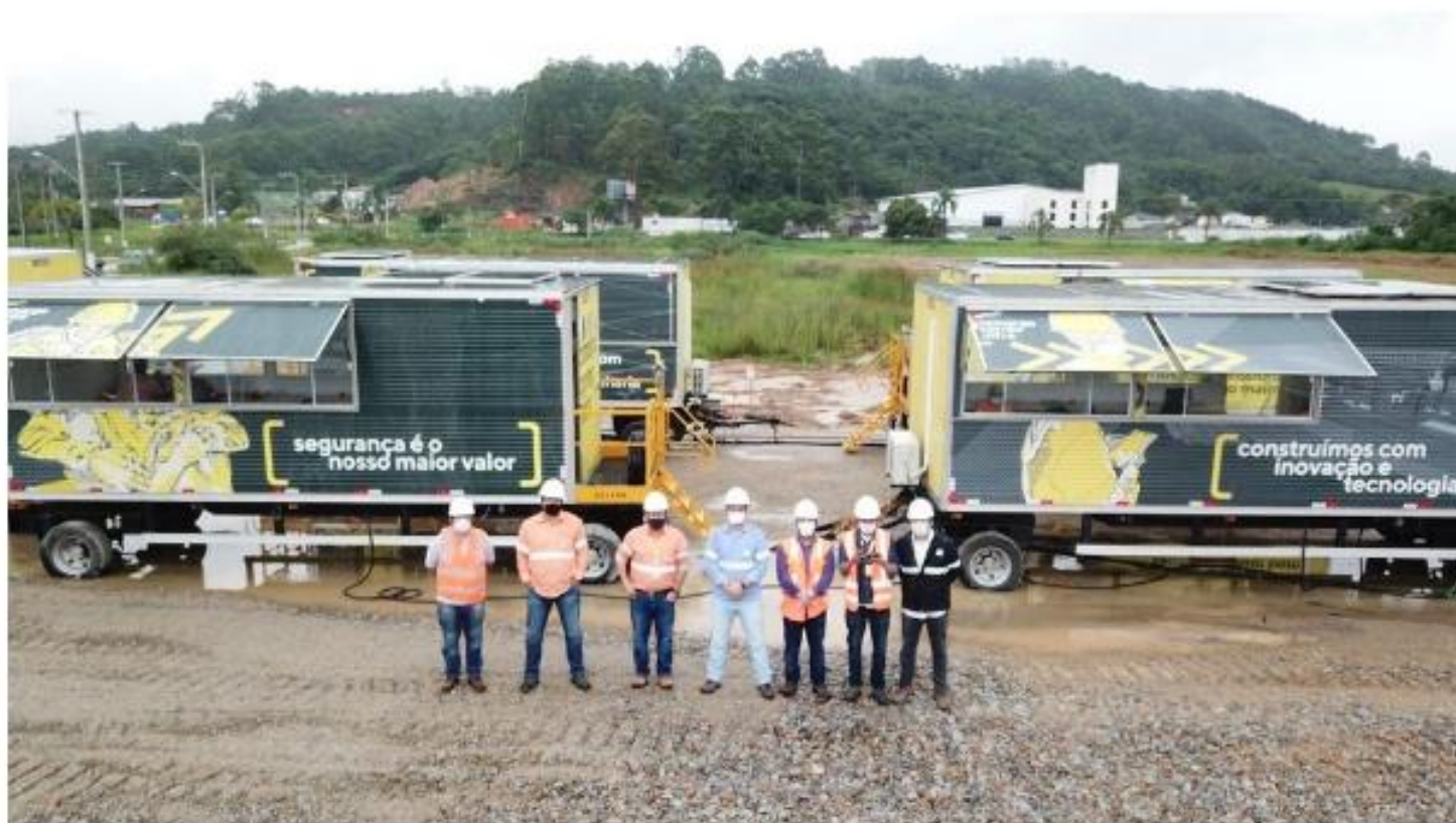
Contêineres customizados garantem agilidade para o início das obras no trecho Sul
