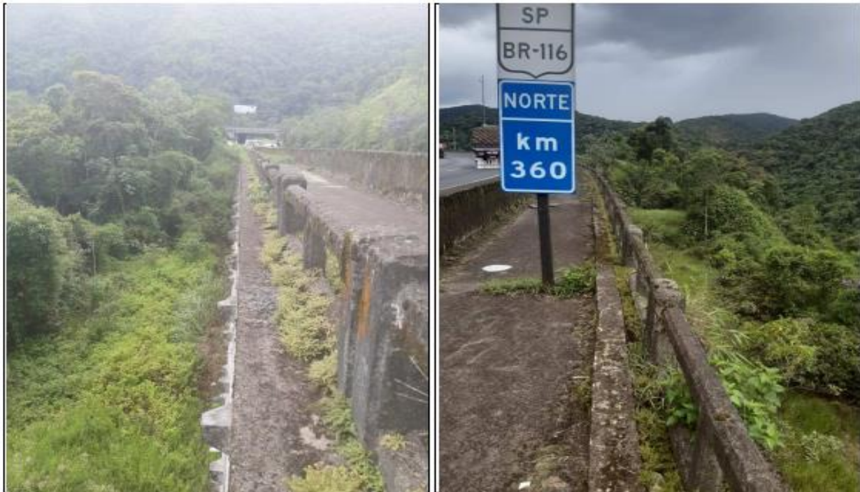
Vista da cortina atirantada sob a rodovia e à montante da ruptura
