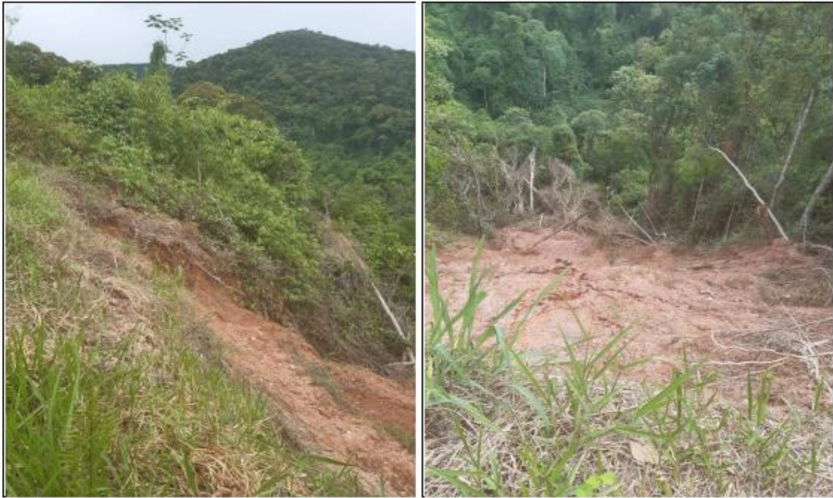
Vista do talude com material rompido
