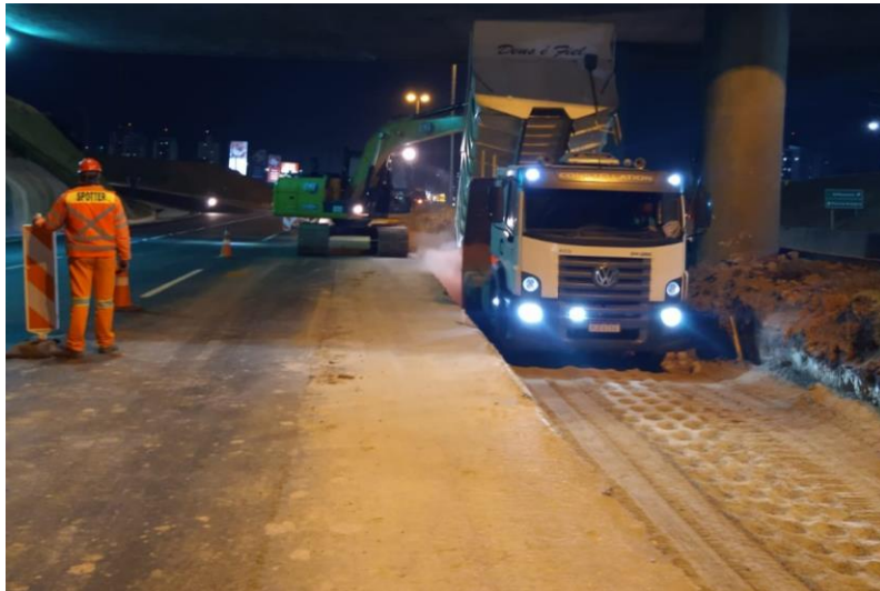
Figura 10 – Travamento faixa 1 – km 205.
