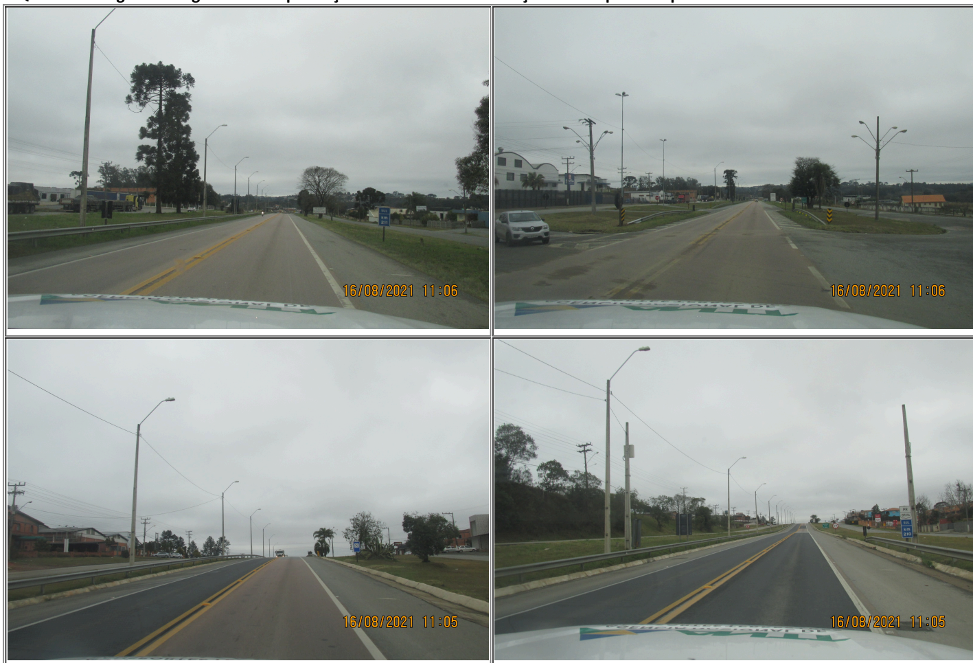
Quadro 2 - Registro fotográfico da implantação de sistema de iluminação em em pista simples entre o km 209+300 e km 211+000
